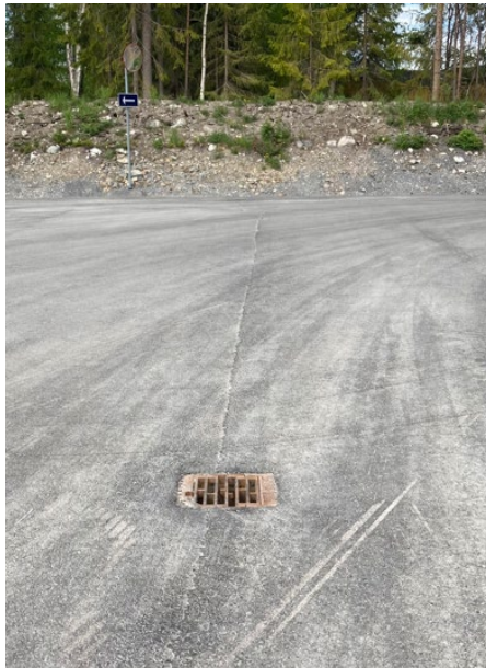
Figur 29. Dagvattenbrunnar på den nya vägen och i dike.
